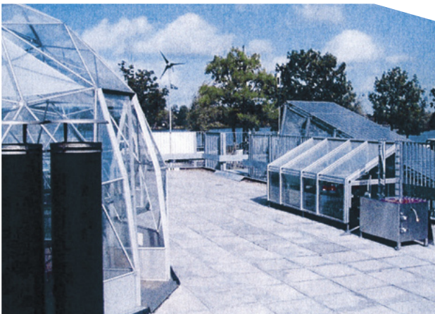
Brændselleanlægget, en af fire vindmøller og det tagintegrerede solcelleanlæg i baggrunden.
