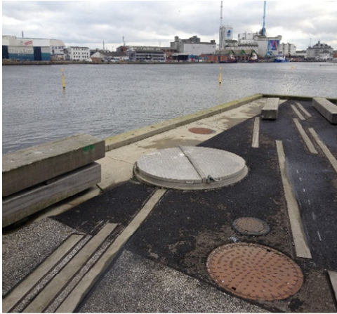
Figur 95 Brønd til havvandsfilter
