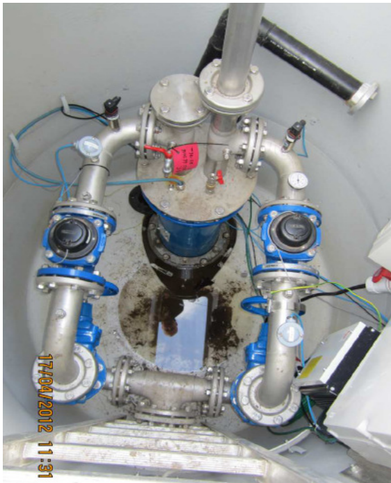
Figur 105 Pumpebrønd til grundvandskøling (COWI A/S)
