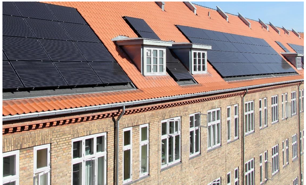
Figur 3-3 Solcelleanlæg som her i boligafdelingen Øbro 95 betyder nok et vist provenutab for staten pga. afgiftsfritagelsen af egetforbruget, men bygningsintegrerede solcelleanlæg giver almindelige forbrugere bedre mulighed for at deltage aktivt i den grønne omstilling af energisystemet.
