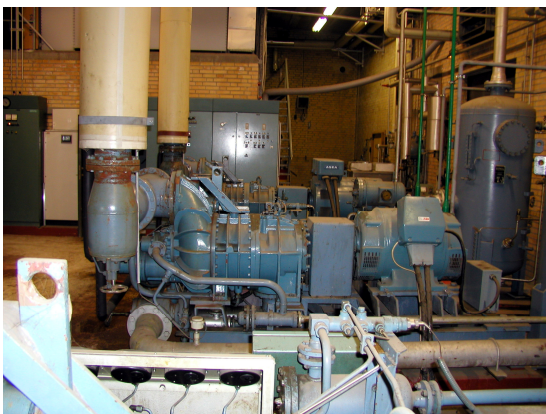
Figur 4.4. Kølekompressorer hos Frigoscandia, der er omfattet af afbrydelighed.
