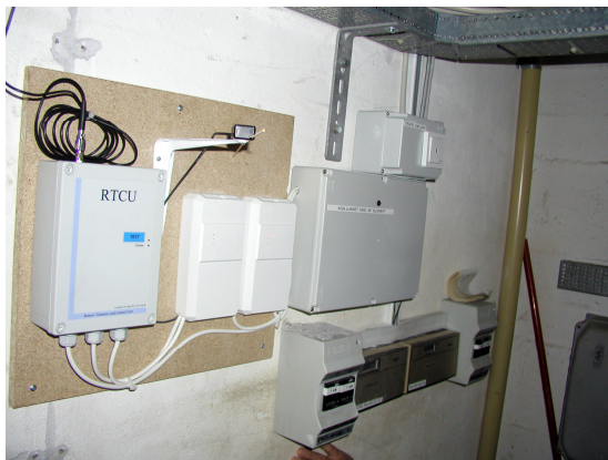
Figur 4.6. RTCU-A9i MAX, transmitter og én modtager samt styrerelæ for ventilationsanlæg.
