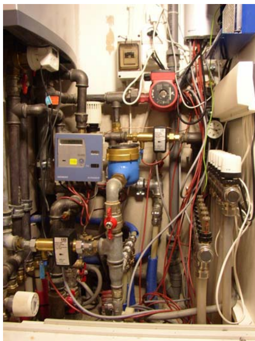
Figur 8. Fjernvarmeinstallationen i forsøgshuset i Lemvig. Pladeveksleren til fremstilling af varmt brugsvand ses øverste til venstre. I højre side af billedet ses shuntaggregat og pumpe.
