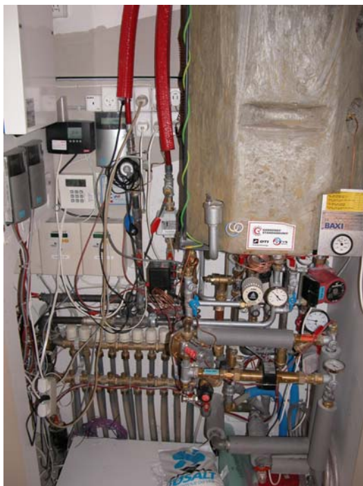
Figur 7. Fjernvarmeinstallationen i forsøgshuset i Brøndby. Shunt aggregat ses nederst til venstre. Øverst til højre ses en isoleret beholder der indeholder varmtvandsbeholder og varmeveksler.
