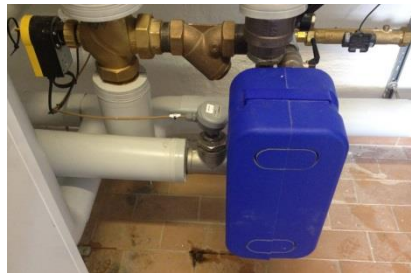
Billede 6: Varmeveksler og motorventil
