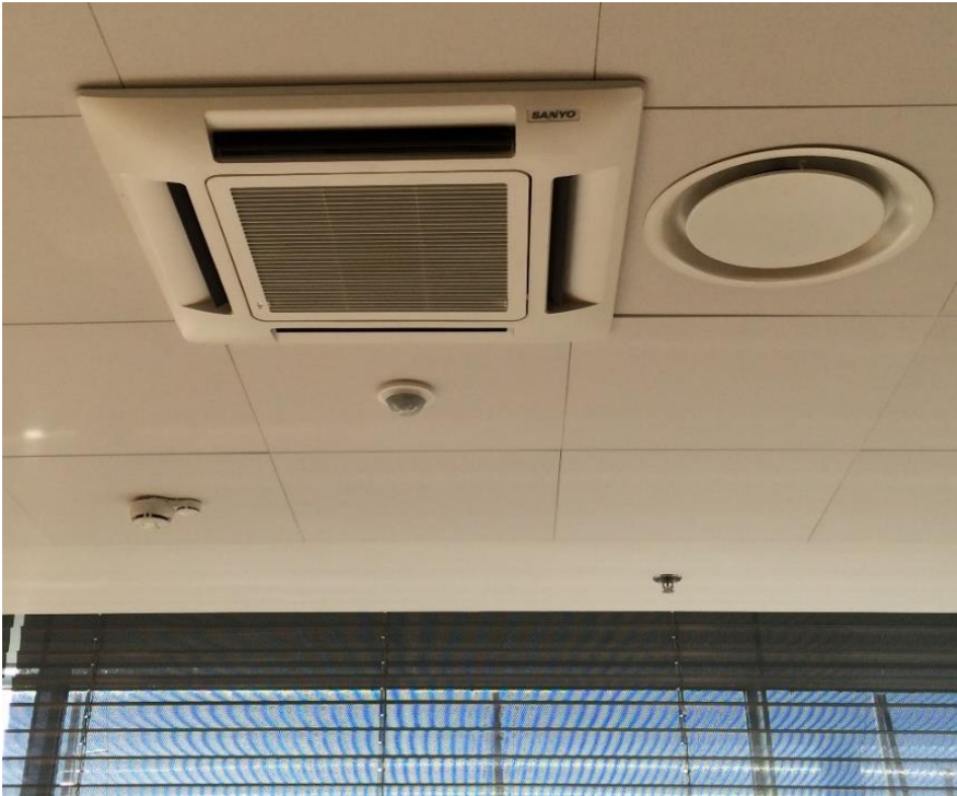
Figur 14 - Placering af aircondition ved siden af mekanisk ventilationsarmatur
