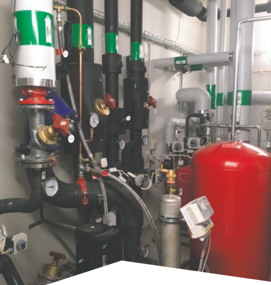
Klimaanlæggets energicentral i Jönköping.
