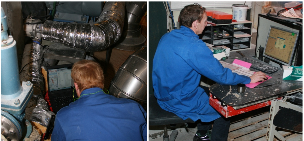
Figur 50. Tv: Jens Mikkelsen optager en vibrationsmåling. Th: Mogens Weel tjekker hvor driften ligger i kompressormappen ud fra driftsdata på overvågningsskærm.
