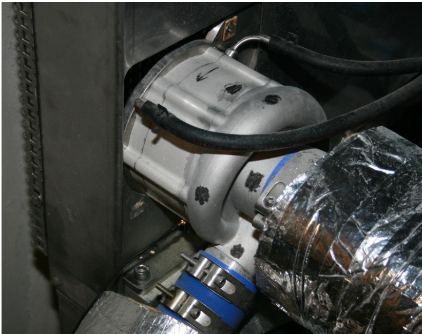
Figur 44. Spotmarkering med sort tusch på blanke flader, for på et mere ens grundlag at kunne sammenligne temperaturmåling med IR kamera (mere ens emissivitet).
