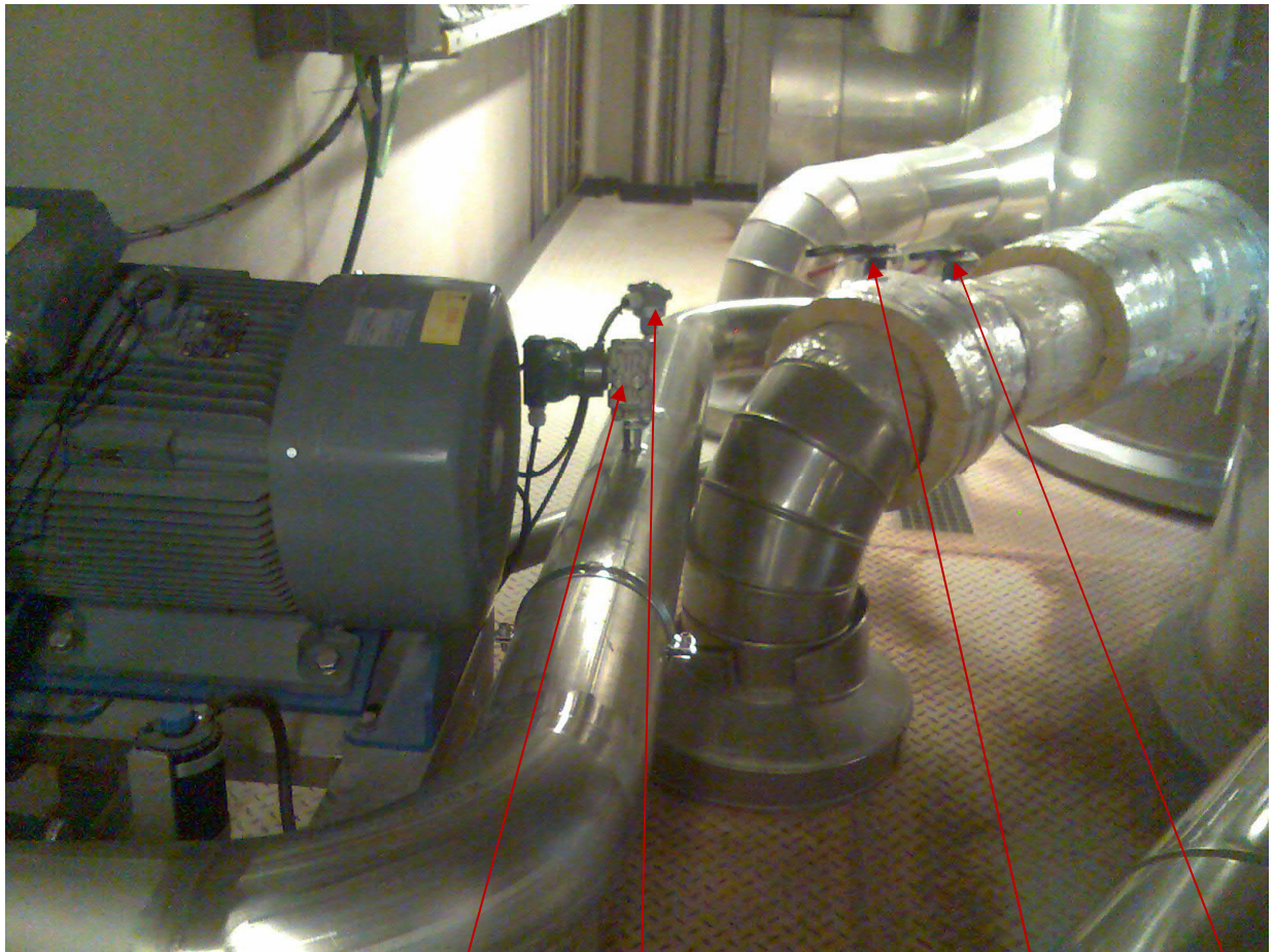
Figur 34. Sugeledning DN150 med trykføler og temperaturføler. Efter bøjningen ses suge- og bypass-ventil, hvor sidstnævnte er placeret cirka en halv meter nedstrøms, hvor der suges fra.
