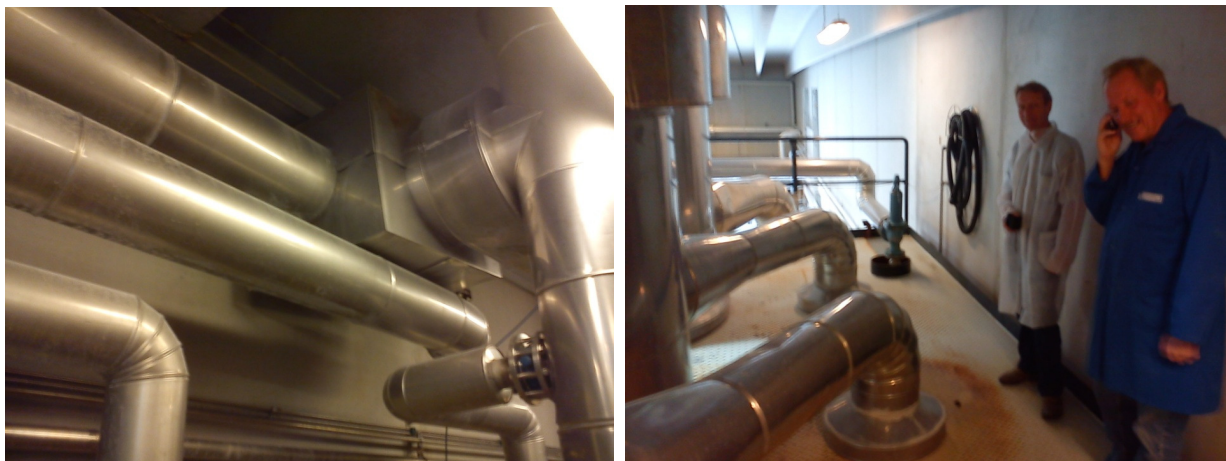
Figur 29. Til venstre: Billede af ejektor (indkapslet i isolering med beskyttelseskapper). Det lodrette rør helt til højre i billedet er afkast damp fra 2. trin på inddamperen, som ejektoren suger fra inden røret fortsætter videre op gennem dækket og ind på 3. trin.
