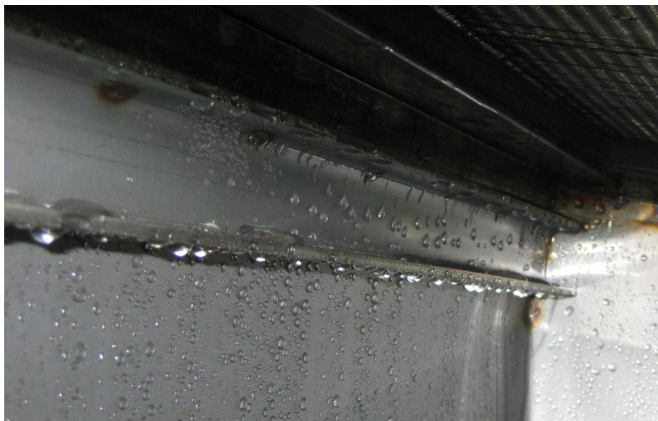
Figur 5.14: Inderside af vaskeanlæggets udsugning.
