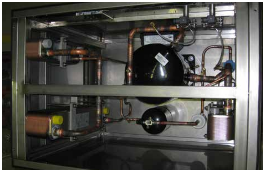
Hovedkomponenter i kabinettet til varmepumpe i demonstrationsanlægget hos Grundfos.
