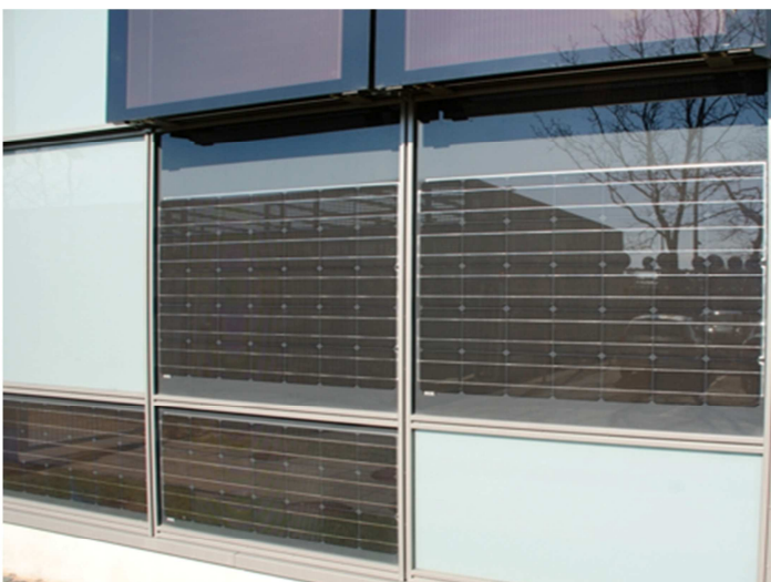
Figur 3.5 Krystallinske solceller integreret i facaden.
