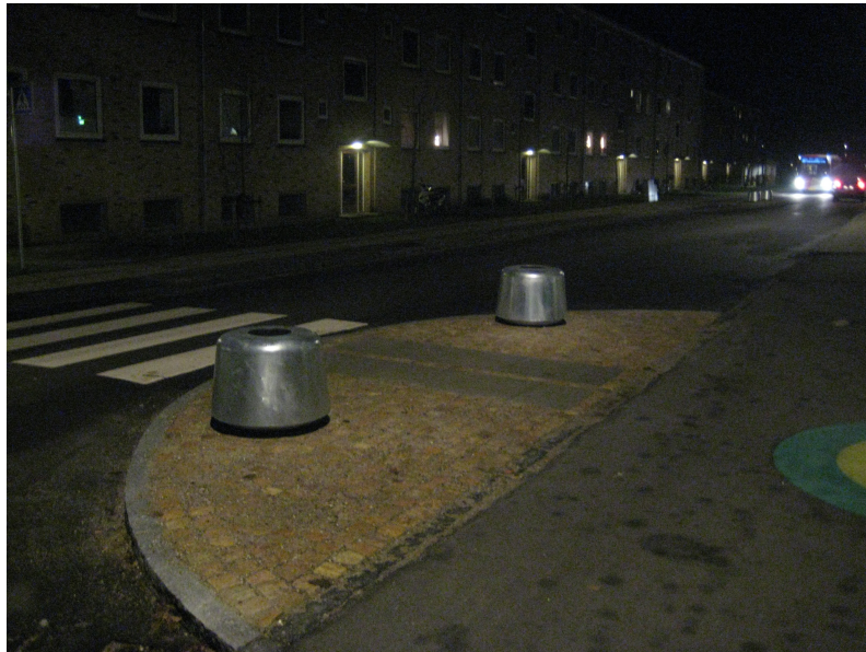
Foto: De 16 x DOT opsat ved 8 vejindsnævninger på Motalavej i Korsør (Slagelse Kommune). Fotoet er taget før der var monteret lysenheder.
