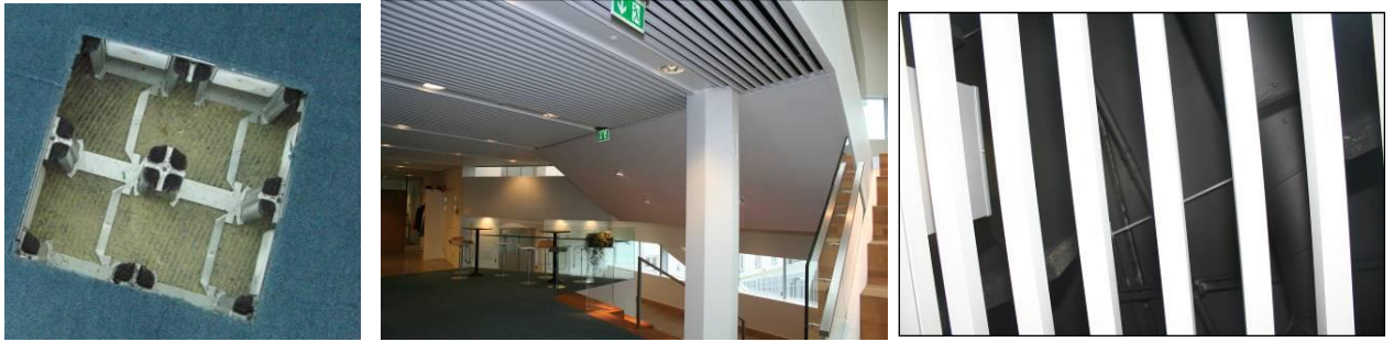
Figur 6 Nedhængt loft med akustikløsning i et typisk kontorområde i Middelfart Sparekasse. Åbningsgraden i loftet er afstemt med, at der kan opnås god køleydelse fra de termoaktive konstruktioner. Der ligger akustikflåder oven på tremmeloftet, der er udført i alu-profiler. Oven på dækkonstruktionen findes et edb-gulv og gulvtæppe (billede til venstre).
