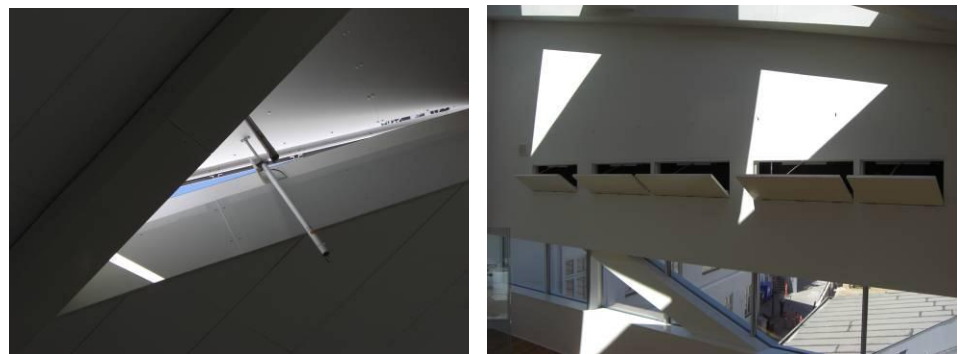
Figur 4 Automatisk styrede åbninger for den naturlige ventilation. Åbning i tag (billede til venstre). Åbninger i facade (billede til højre)
