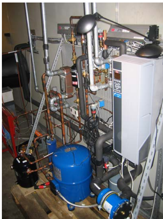
Figur 6 Kølesystemet er opbygget meget kompakt og er placeret udenfor klimakammeret. I midten ses den blå kompressor, som kan køre med variabel hastighed ved hjælp af frekvensomformerer til højre i billedet.
