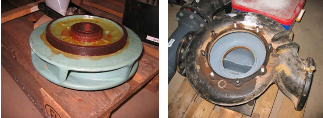
Billede 12: Coated løber og pumpehus efter 8 måneders drift.
