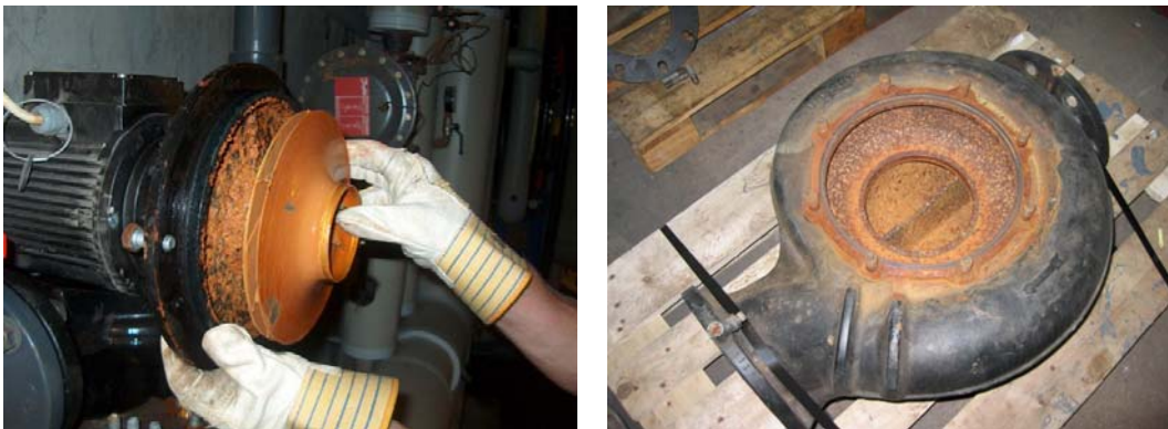
Billede 11: Pumpehus og løber efter drift i klorvand i ca 10 år.
