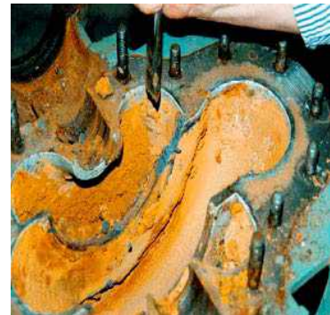
Billede 1: Korroderet pumpehus. Kilde: Chesterton
