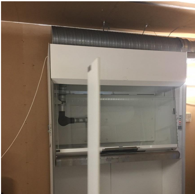
Figur 8.1 – Forsøgsopstilling med stinkskabet i baggrunden og den mekaniske plade i forgrunden. I forsøgene var den viste sugearm ikke installeret. Lugen var på skift fuldt åben og lukket under forsøget.
