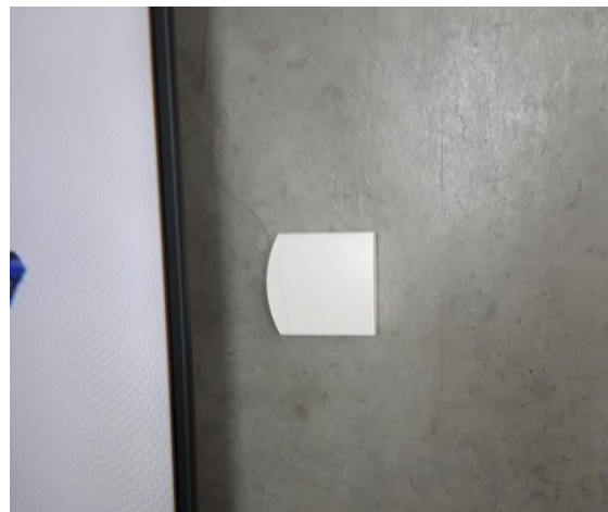
Figur 1 - Måske ikke nemt at se, men dette er en føler placeret i umiddelbar nærhed af et TV. Varmeudvikling fra skærmen påvirker temperaturmålingen, og gør de pågældende data ubrugelige.
