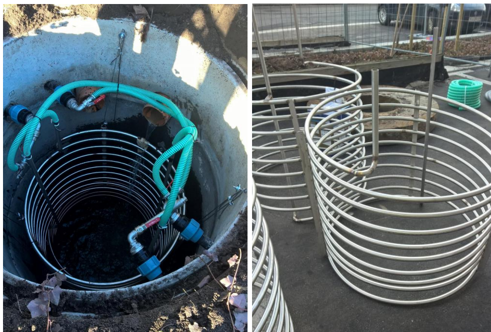
Figur 8: T.V. under montage med midlertidige rørinstallationer og før installation af spildevandspumpen. T.H. foto af vekslerne før montagen.
