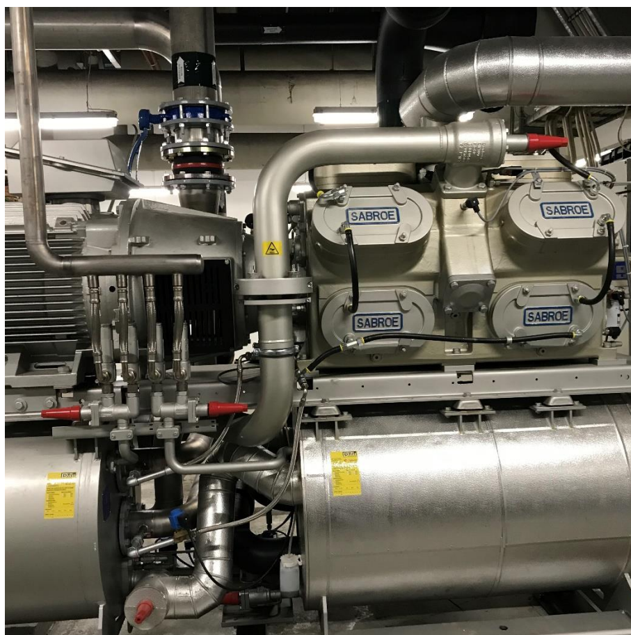
Figur 8.27. SABROE ChillPac112L der er udrustet med en SMC112L stempelkompressor
