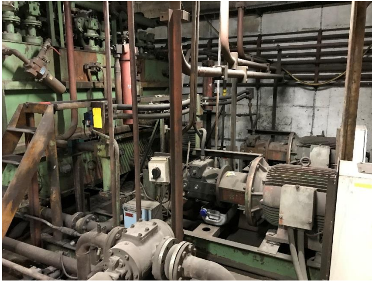
Figur 8.37. Hydraulikpumper og motorer
