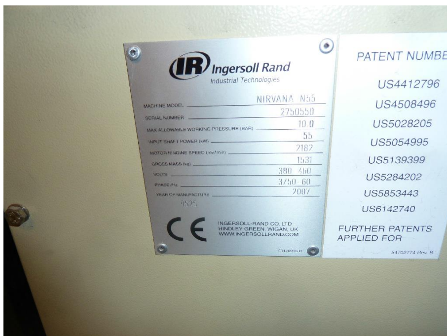
Figur 8.13. Mærkeplade på kompressor 1
