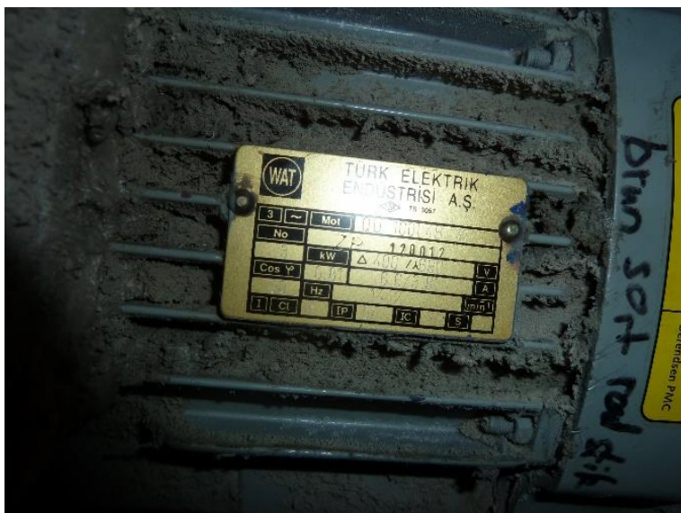
Figur 8.2. Mærkeplade på motor på hydraulikstation nr. 2
