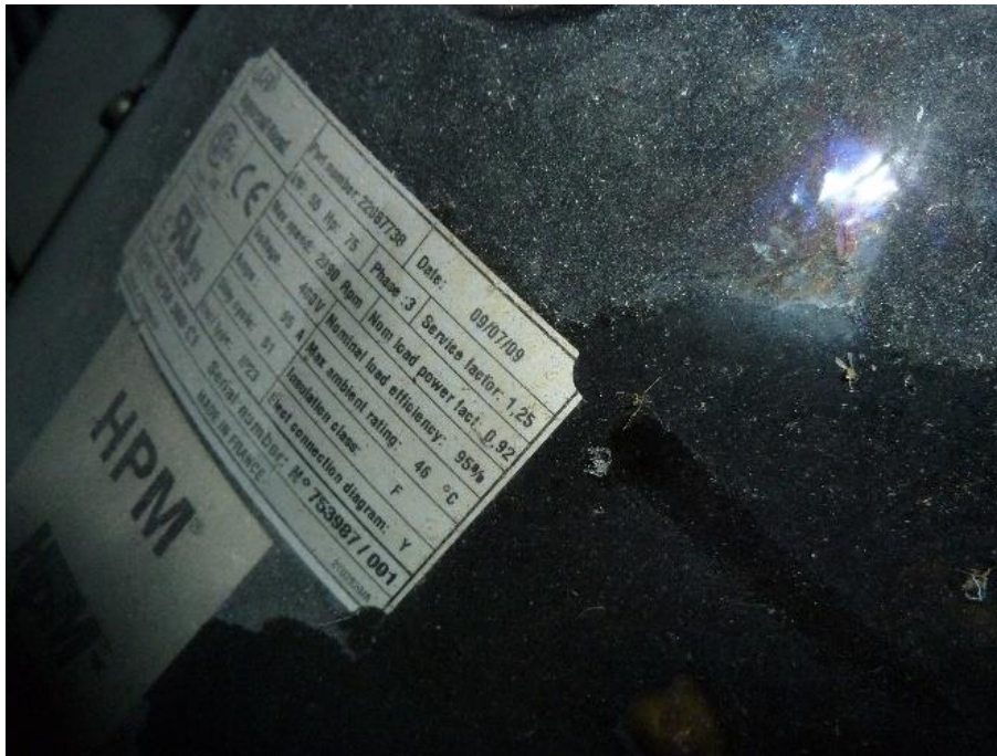
Figur 8.14. Mærkeplade på hovedmotor trykluftkompressor nr. 1
