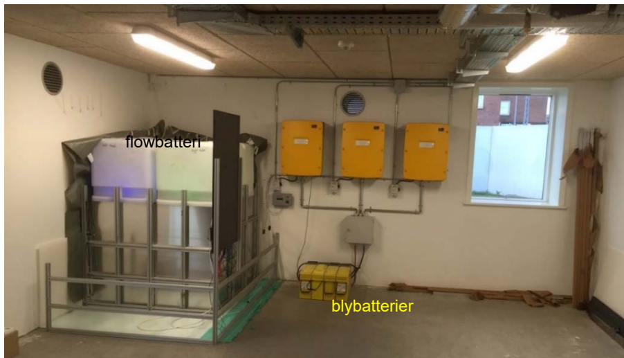
Figur 3.18. Flowbatterier under montage i bygningens serviceetage. Blybatteriet er til midlertidig brug i forbindelse med installation og indkøring af flowbatteriet.
