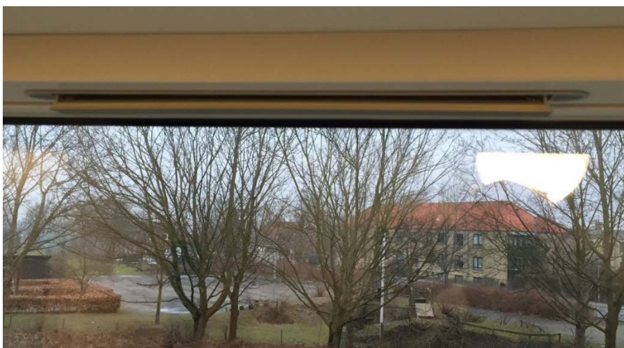
Figur 5.14 Udeluftventil i toppen af et af vinduerne i trappegangen.
