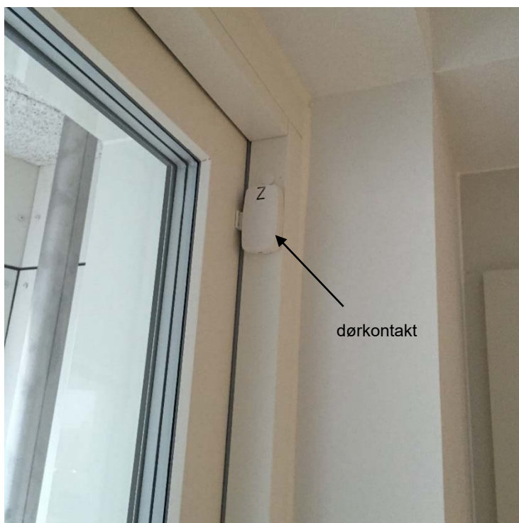
Figur 4.4 Kontakt til detektering af åbning og lukning af altandør.
