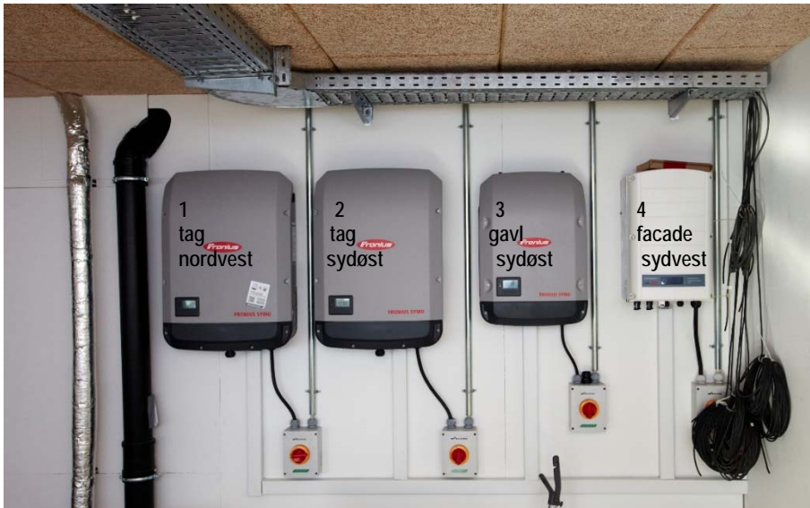
Figur 3.16 Solcelleanlæggenes fire invertere placeret i serviceetagen.
