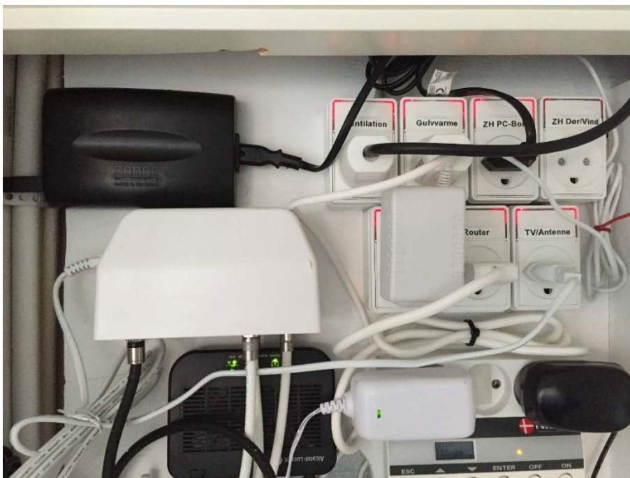
Figur 4.5 zensehome stikkontakter i teknikrummet i en af lejlighederne.
