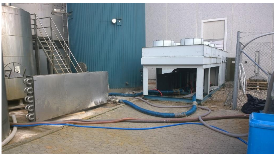
Figur 2 viser varmevekslingstest på spildevand udført hos BHJ.
