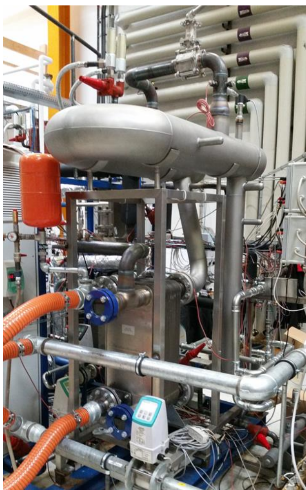
Figur 1. Ammoniakchiller. Fordamper er monteret med to udløb.
