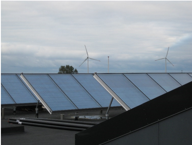
Figur 122 Solfangeranlæg (Arcon-Sunmark A/S)
