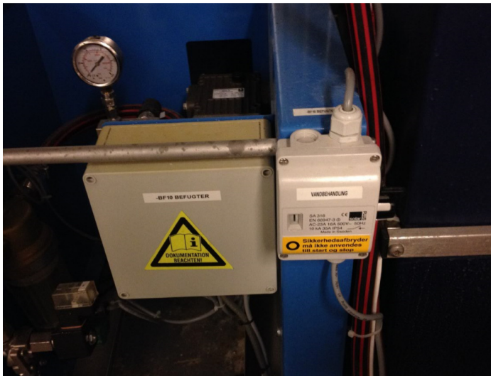
Figur 131 Detalje fra vandbehandlingsanlæg
