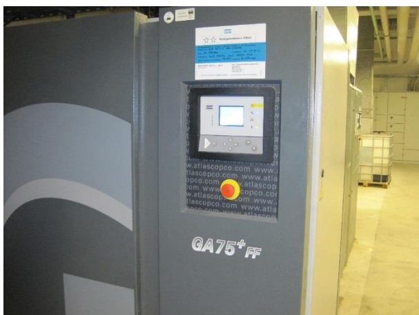
Figur 4.9 Kompressor 1 - GA 75 FF
