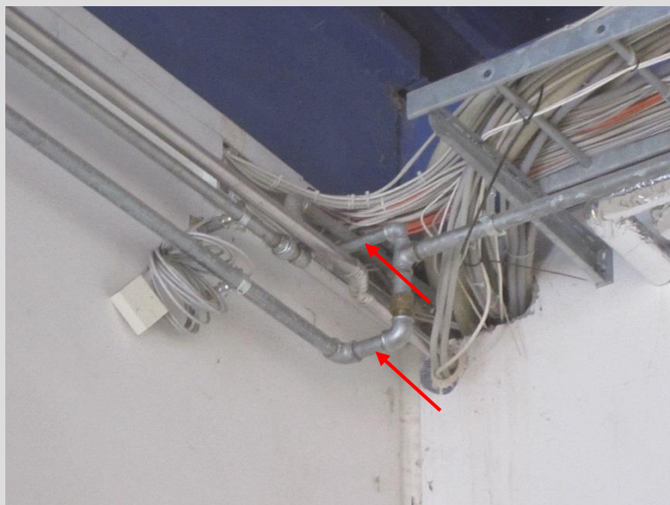
Figur 5.27 Rørstrækninger med for små dimensioner (røde pile).
