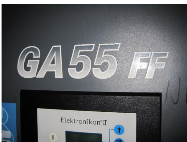
Figur 4.11 Kompressor 2 - GA 55 FF
