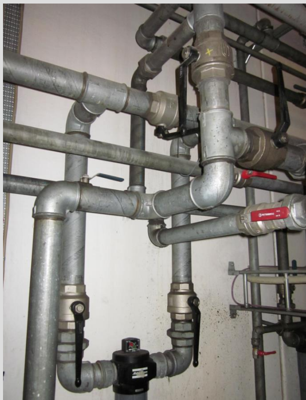
Figur 5.71. Rørsystem i kompressorcentral.
