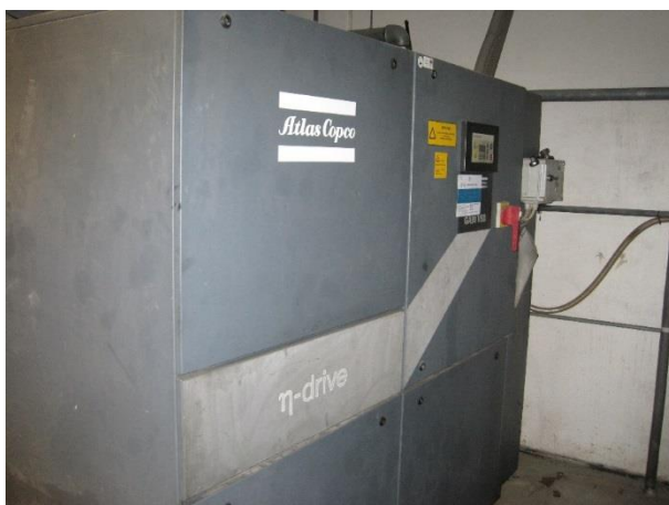
Figur 4.15 Kompressor 4 - GA 90 VSD
