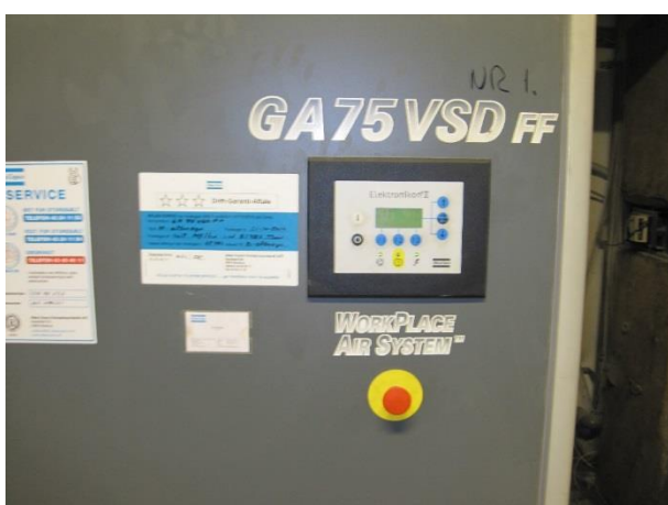
Figur 4.13 Kompressor 3 - GA 75 VSD
