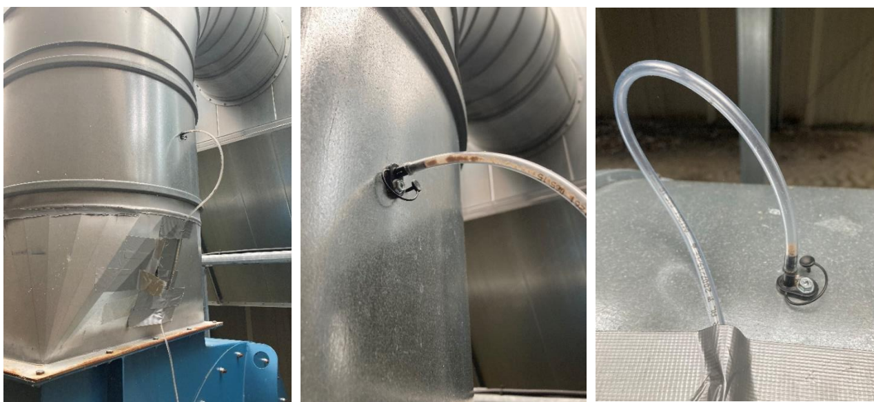
Figur 9.3.14 Trykstudsene placeret på hver side af udsugningsventilatoren.
