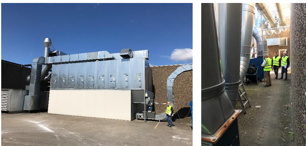
Figur 10.2.1 Filteranlæg (tv) og tre procesudsugningsventilatorer (th).
