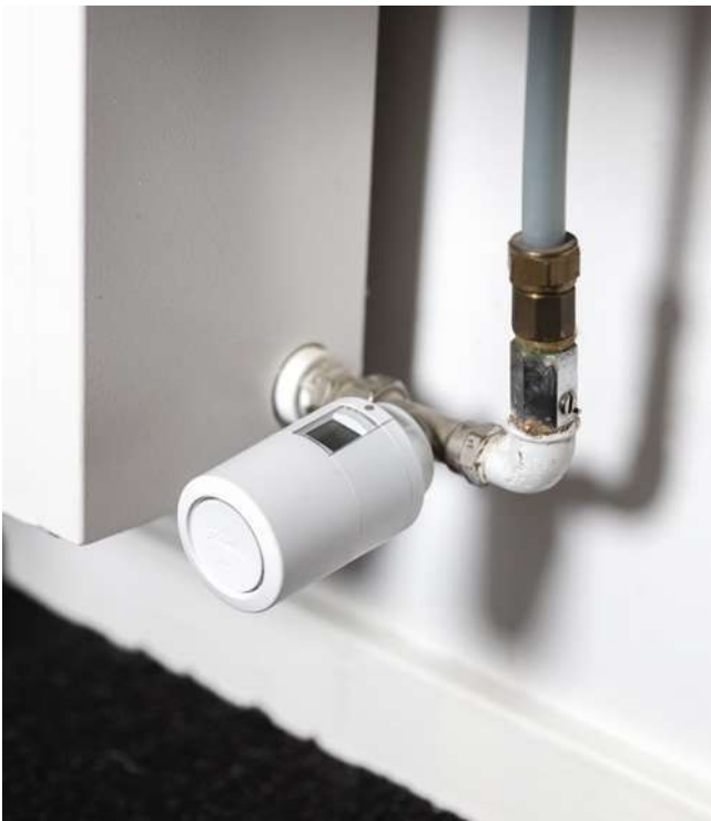
Nye Danfoss-termostater hos Implement Consulting Group skal bidrage til et bedre indeklimate og en mere effektiv temperaturstyring.
