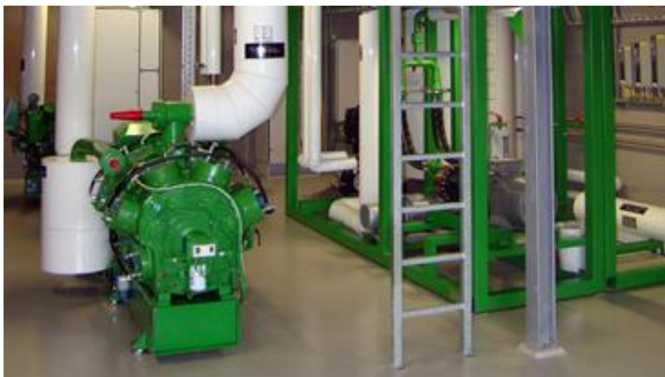
Figur 6.17 Hybridvarmepumpe installeret hos Arla, Videbæk, der leverer 85 °C varmt vand [1].
