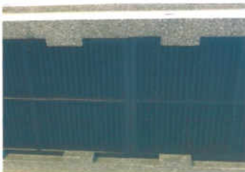
Figur 7 Varmevekslere (regenerative, af plast) monteret i kanal på ude-siden. Monteret ved alle målinger.
