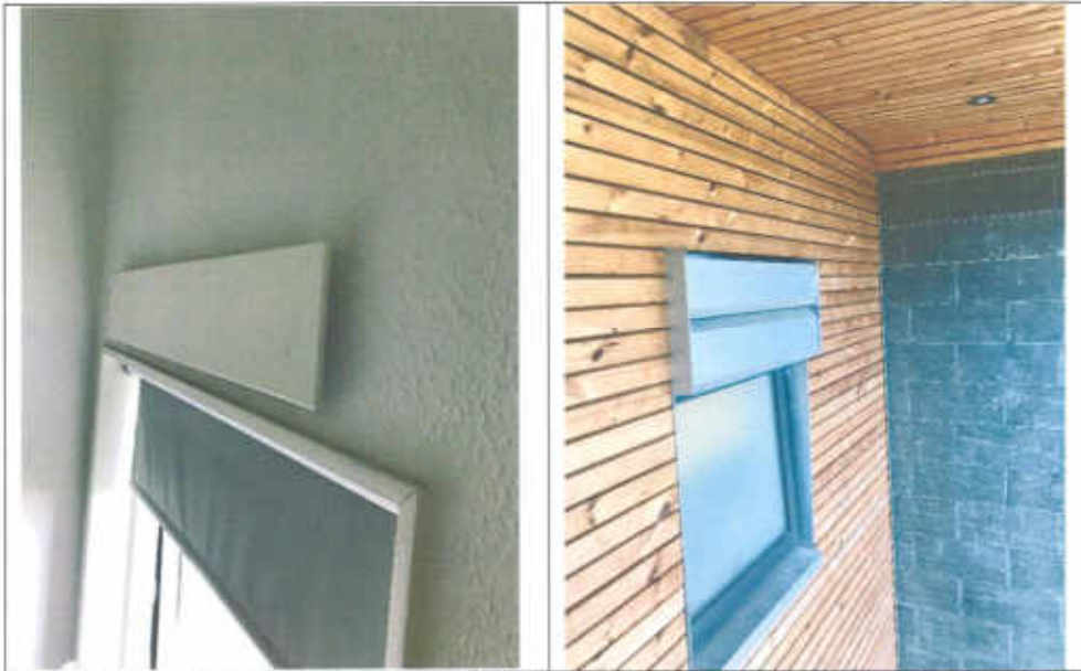
Ventilationsenhed set indefra (værelse) og dobbelt ventilationsenhed set udefra (bad).
