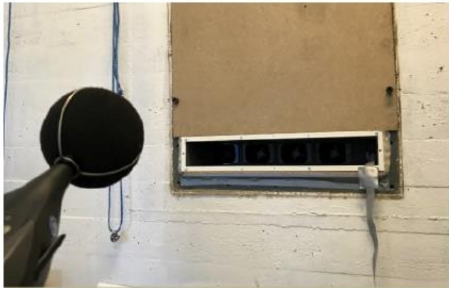
Figur 1 Måleposition 1 meter foran indvendig åbning af MicroVent (4 blæsere)
