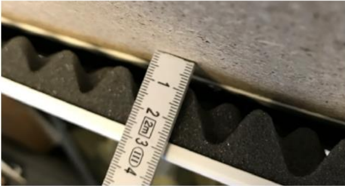
Figur 4 Eksempel på lydabsorbent monteret på flade af afdækningskærm ind mod kanalen.
