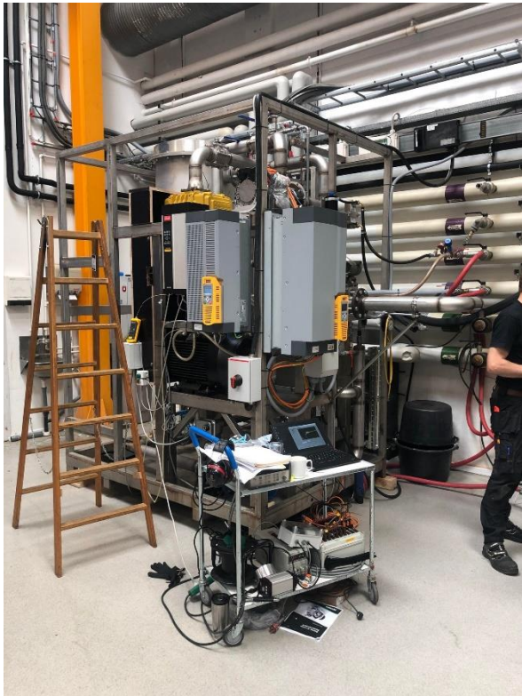
Overblik over anlægget i forbindelse med indkøringen af systemet. Computeren på rullebordet overvåges og bruges til at se, hvordan ændringerne påvirker systemet.
